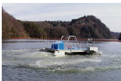
写真 4.2.5-3 循環曝気設備稼働状況 (平成 26 年 5 月)
