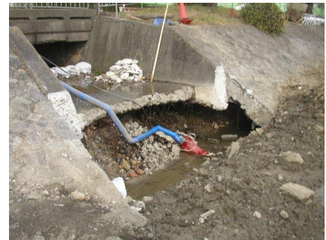
写真3.6-1 護岸空洞化の状況写真 (平成19年1月に瀬田川で発見)
