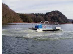
写真 4.2.5-3 循環曝気設備稼働状況
