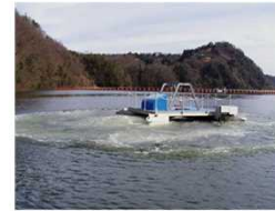
写真 4.2.5-3 循環曝気設備稼働状況
