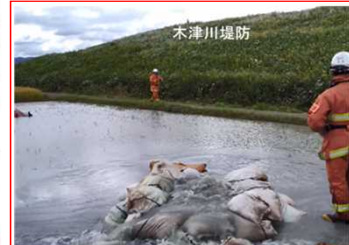
写真 3.3.1-14 木津川における堤防漏水の状況 (平成29年台風21号)
