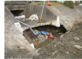
写真3.6-1 護岸空洞化の状況写真 (平成19年1月に瀬田川で発見)
