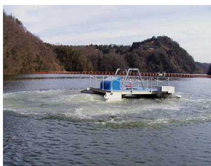
写真 4.2.5-3 循環曝気設備稼働状況
