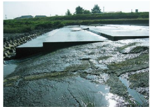
写真 3.2.1-1 魚類等の遡上・降下の阻害となっている横断工作物 高木井堰(猪名川)
