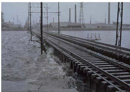
写真 3.3.2-1 昭和36年9号台風時の阪神電鉄西大阪線橋梁の状況
