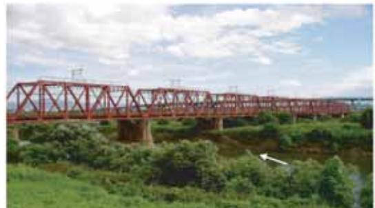
写真 3.6-2 河道内樹木の繁茂状況(木津川)
