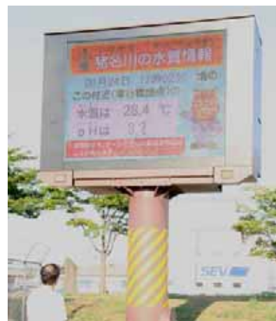
写真 4.3.1-1 河川情報表示板
