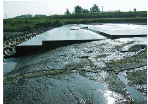
写真 3.2.1-1 魚類等の遡上・効果の阻害となっている横断工作物 高木井堰(猪)
