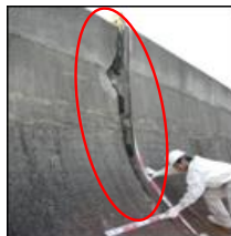
特殊堤の変状
