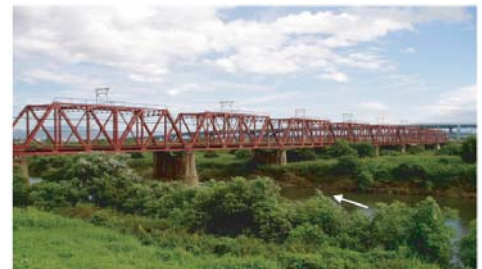
写真 3.6-2 河道内樹木の繁茂状況(木津川)
