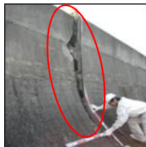
特殊堤の変状
