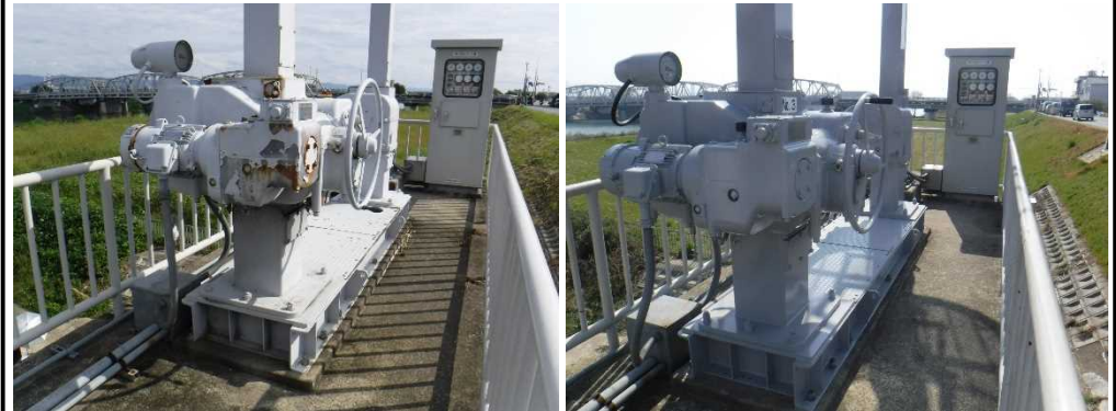
対策前(新川樋門 開閉器)
