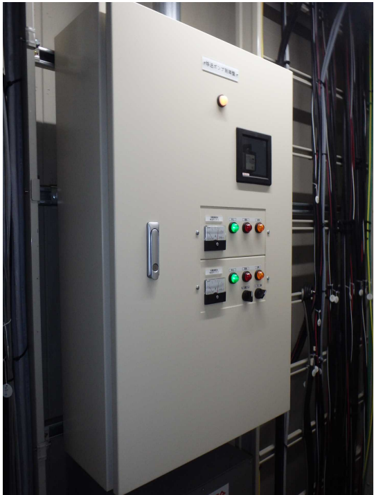
3階に移設した制御盤
