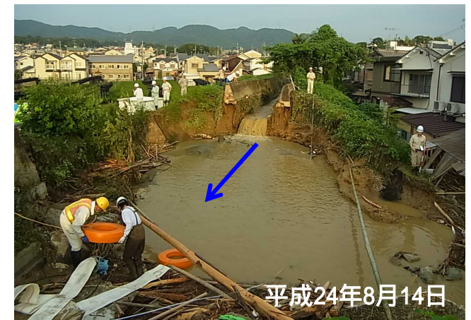
被害状況(平成24年)弥陀次郎川決壊箇所
