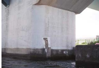
門柱部のコンクリートの剥離
