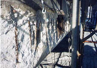
3号堰柱操作台の鉄筋腐食状況
