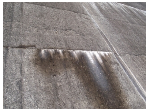
下流堤体面の漏水状況確認
