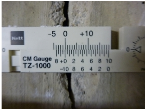
堤体内クラック幅 (クラックゲージ)の観測
