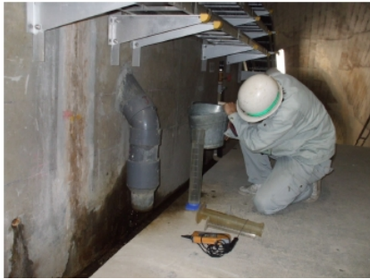
継目排水孔からの漏水量の計測
