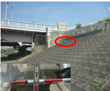
破損状況(H25点検時)
