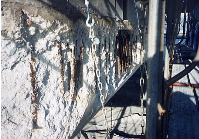
3号堰柱操作台の鉄筋腐食状況
