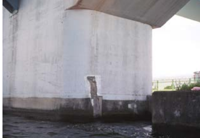
門柱部のコンクリートの剥離
