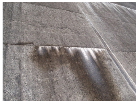
下流堤体面の漏水状況確認
