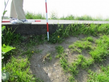
破損状況(H25点検時)
