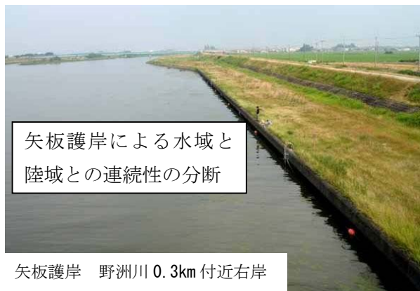
写真-1 横断方向の連続性の分断
