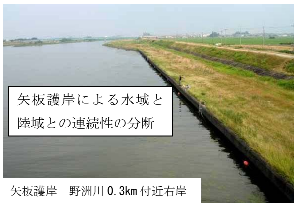
写真-1 横断方向の連続性の分断
