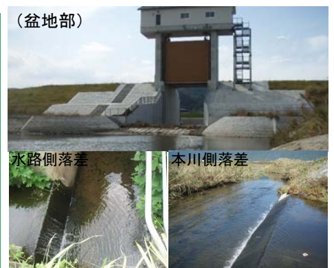
写真-1 支川との落差の例(上野遊水地)
