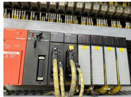
PLC不具合（エラーランプ点灯）
