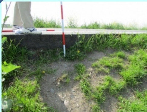
破損状況(H25点検時)
