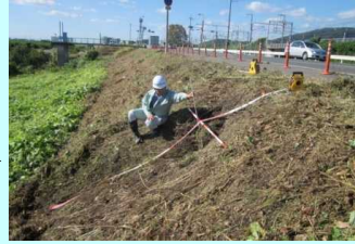
除草後、堤防点検(法面が若干陥没した箇所を発見)
