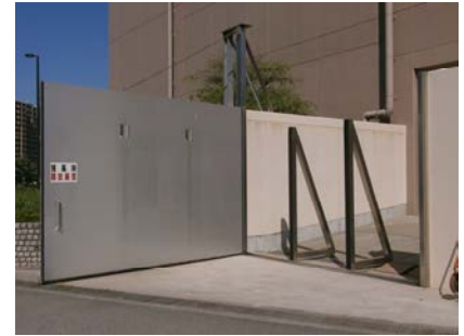
発電機棟防潮扉
