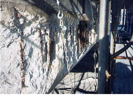
3号堰柱操作台の鉄筋腐食状況
