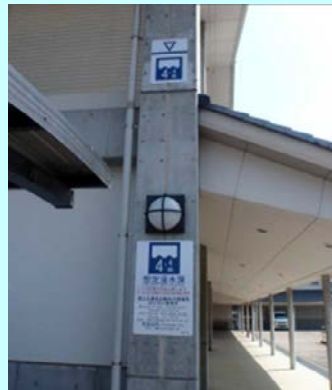
京田辺市 中部住民センター設置事例
