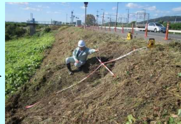
除草後、堤防点検(法面が若干陥没した箇所を発見)
