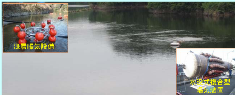
布目ダム 曝気増設状況
