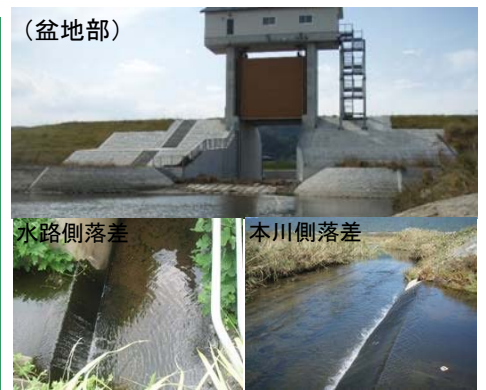
写真-1 支川との落差の例(上野遊水地)
