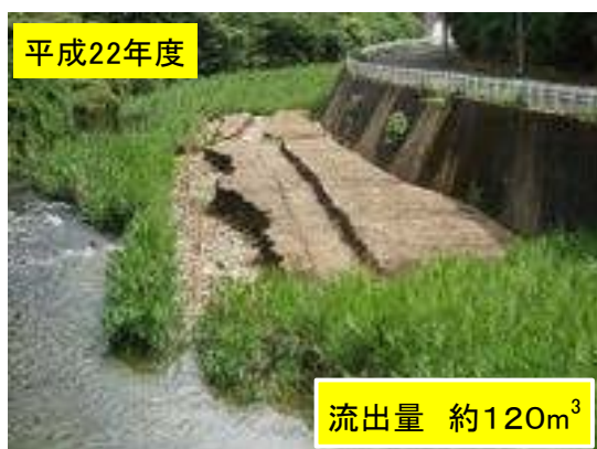
布目ダム出水後の土砂状況
