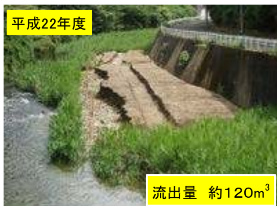
布目ダム出水後の土砂状況
