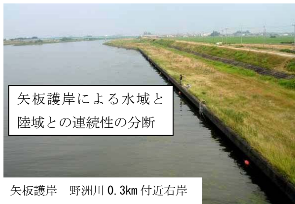
写真-1 横断方向の連続性の分断
