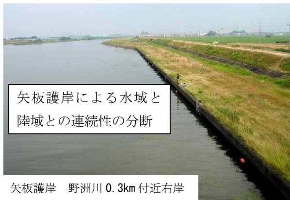
写真-1 横断方向の連続性の分断
