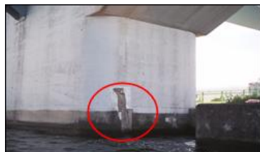
淀川大堰堰柱コンクリートの剥離
