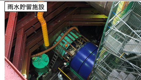
直径3m、延長350mの雨水貯留管整備の掘削立坑(池田市)
