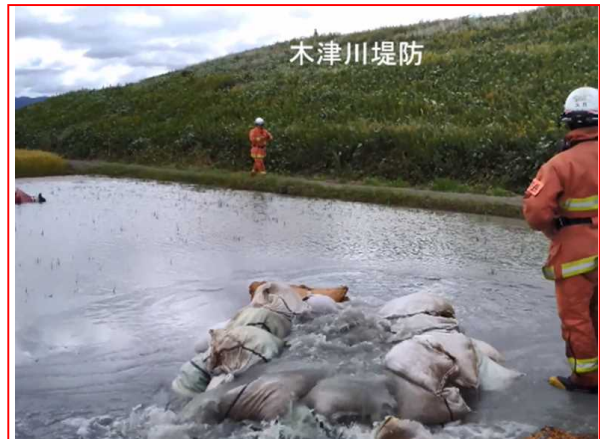
写真 3.3.1-14 木津川における堤防漏水の状況 (平成 29 年台風 21 号)
