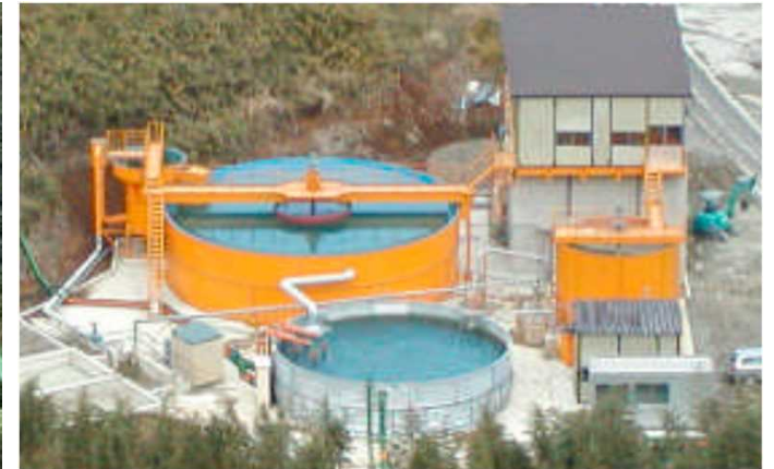
濁水処理施設（他ダム事例）
