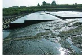
写真 3.2.1-1 魚類等の遡上・降下の阻害となっている横断工作物 高木井堰（猪名川）
