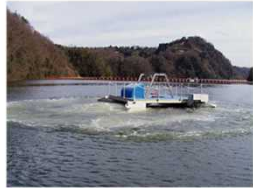
写真 4.2.5-3 循環曝気設備稼働状況
