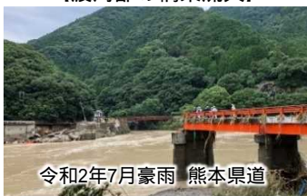
【渡河部の橋梁流失】
