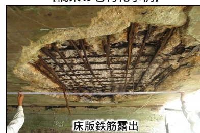
【橋梁の老朽化事例】
