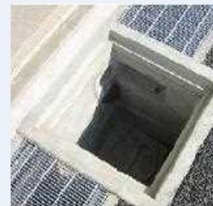
設置している雨水浸透ます
