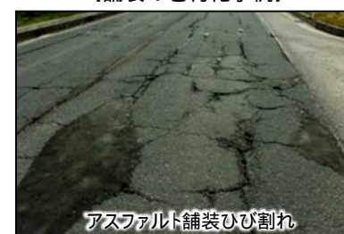
【舗装の老朽化事例】
