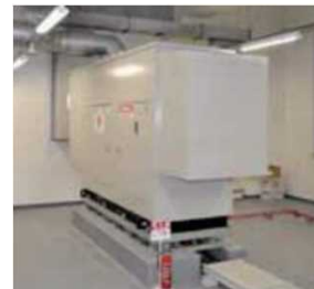
非常用発電設備のイメージ
