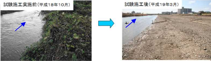
水面と高水敷の落差が大きく、植生が繁茂
