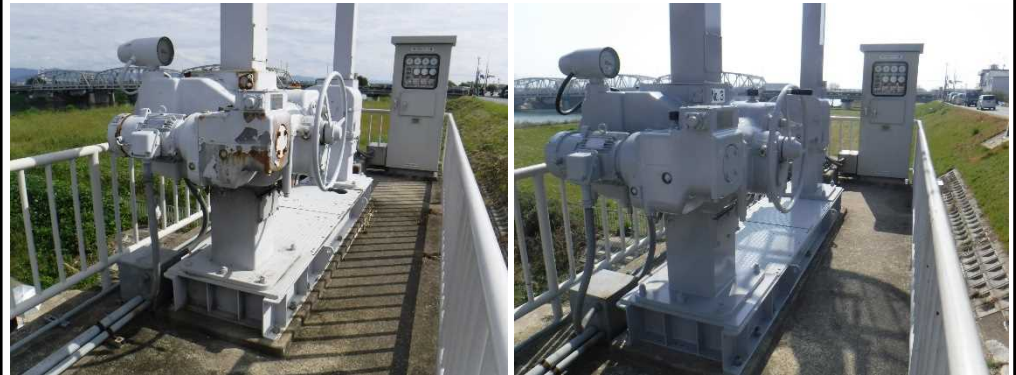
対策前(新川樋門 開閉器)
