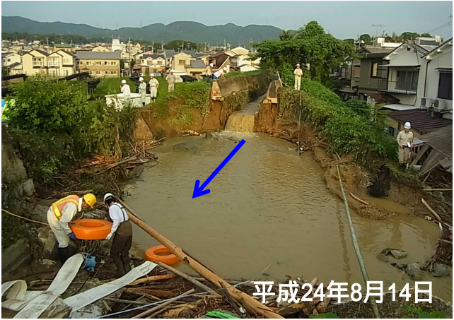
被害状況(平成24年)弥陀次郎川決壊箇所
