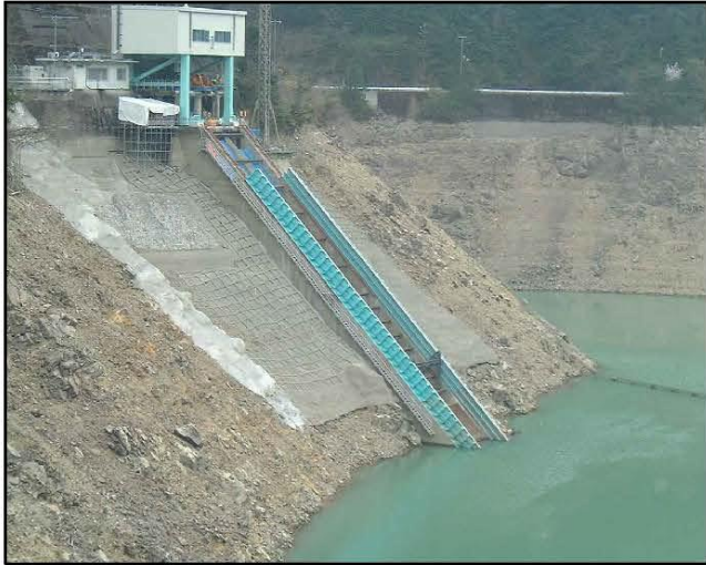
戸当り金物据付状況 （坂本ダム表面取水設備工事の例） ※ 風屋ダムでは設備規模がこれよりも大きくなります。
