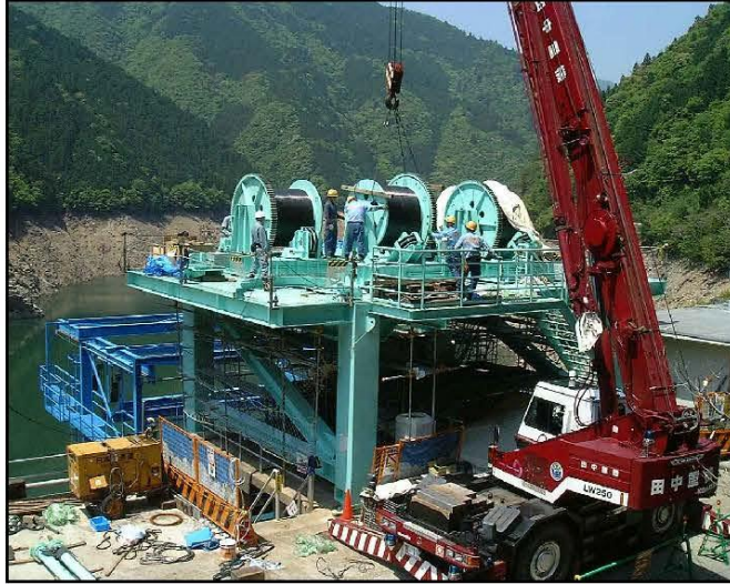
開閉装置据付状況 （坂本ダム表面取水設備工事の例） ※ 風屋ダムでは設備規模がこれよりも大きくなります。
