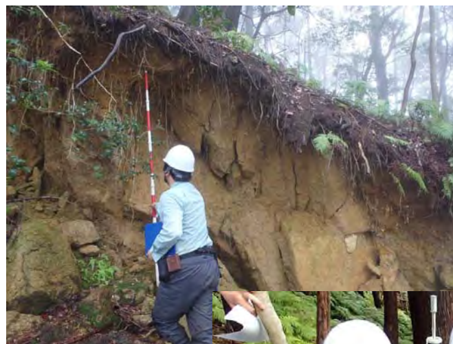
崩壊地調査 (内の川)
