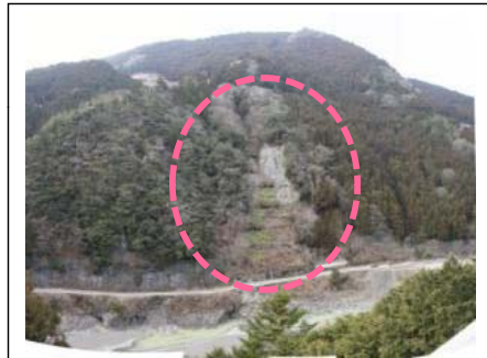
⑪堂平地区 (被災直後) ・地すべり兆候の規模 4.0ha ・対策：アンカー工
