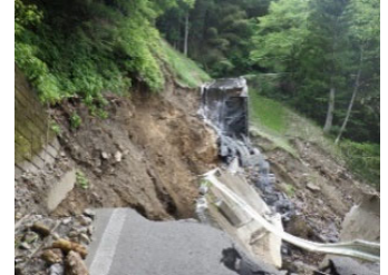
しもいなぐん てんりゅうむら 6/2 長野県下伊那郡龍村 林道の路体が崩落
