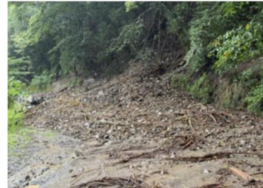
こゆうぐんにしめらそん 9月 宮崎県児湯郡西米良村 山腹崩壊により林道へ土砂流出
