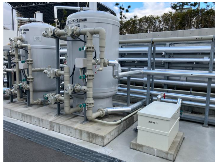
海水ろ過装置・井戸ポンプ
