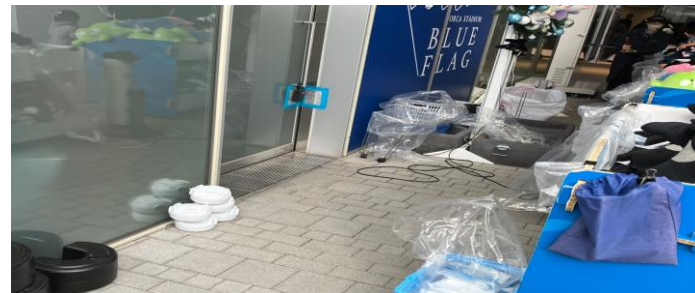
入口付近の排水溝（溢水箇所）
