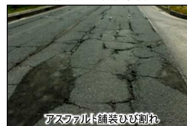
【舗装の老朽化事例】
