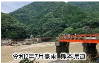
【渡河部の橋梁流失】
