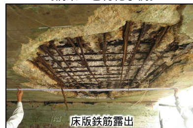
【橋梁の老朽化事例】
