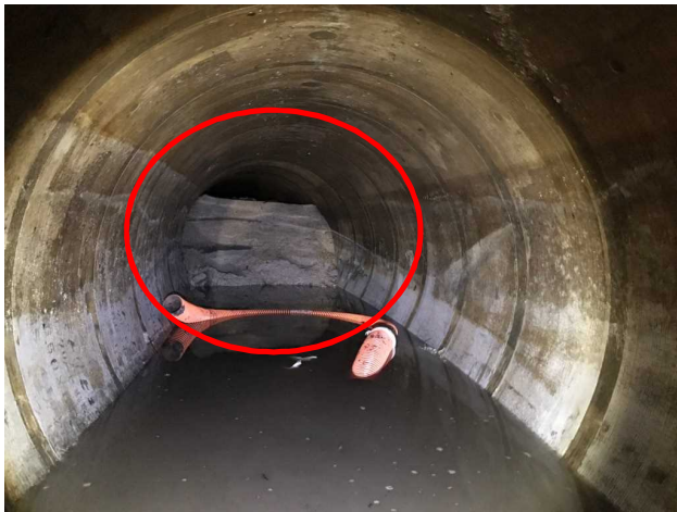
土砂堆積状況
