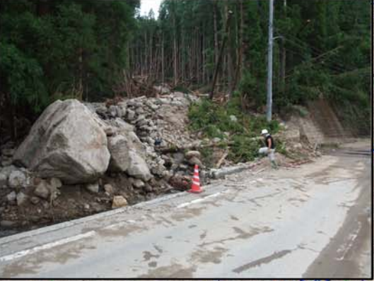
被災状況（新宮市熊野川町赤木赤木谷）
