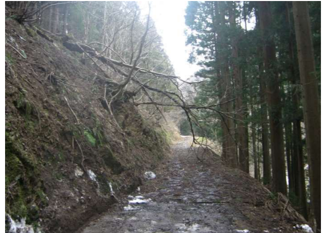
倒木(水源地域の荒廃状況)
