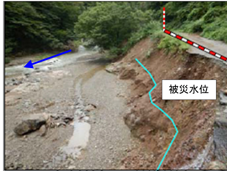
被災直後の状況
