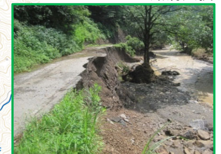
No.49 路肩欠損
