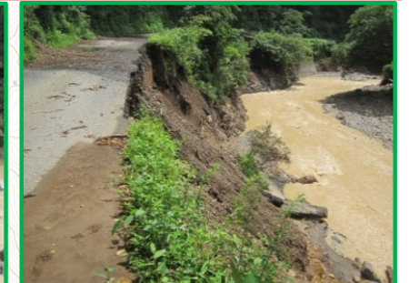
No.56 路肩欠損
