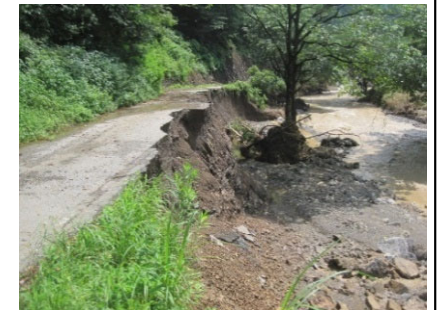
No.49 路肩欠損
