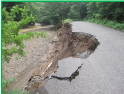
No.75 路肩欠損
