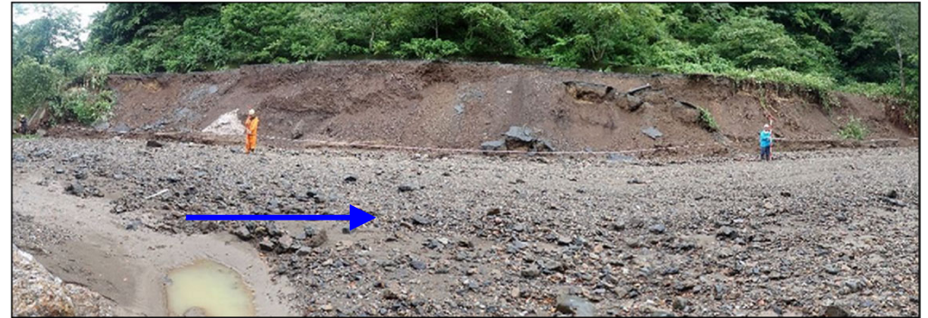
被災直後の状況
