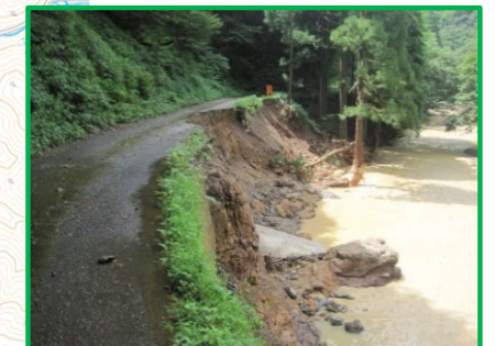
No.54 路肩欠損
