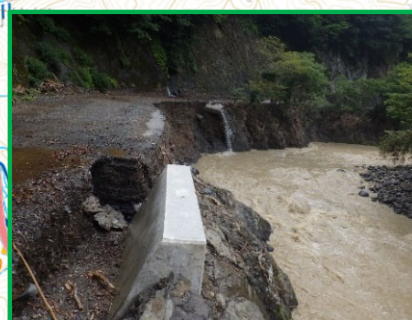
No.21 路肩欠損 【資料4】-3
