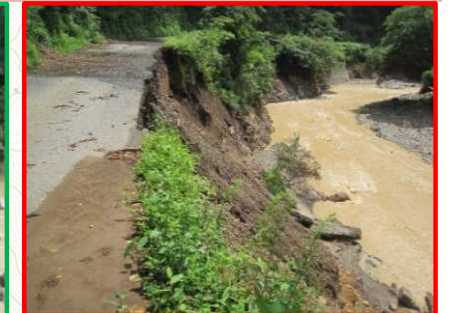
No.56 路肩欠損
