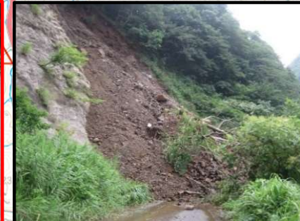
No.73 法面崩壊
