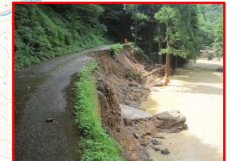
No.54 路肩欠損
