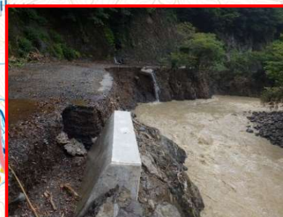
No.21 路肩欠損
