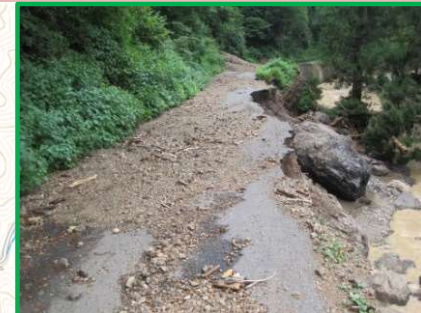
No.60・62 路肩欠損
