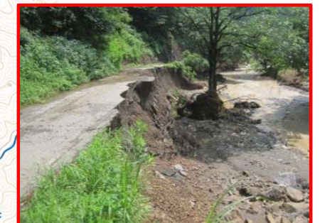
No.49 路肩欠損
