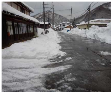
消雪設備整備
