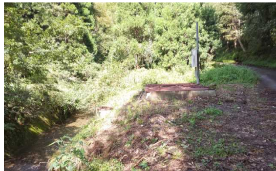
①取水設備
