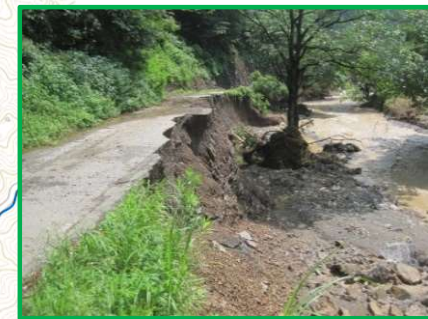
No.49 路肩欠損
