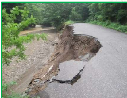
No.75 路肩欠損
