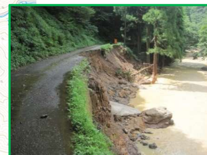
No.54 路肩欠損
