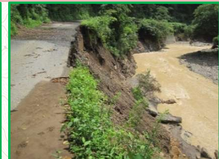
No.56 路肩欠損
