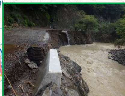
No.21 路肩欠損
