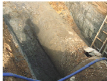
漏水箇所の状況
