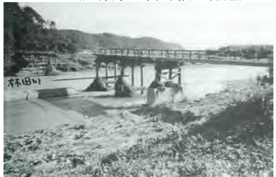
揖保川が土砂で埋没し流路が変わった状況 にしぶか (宍粟市一宮町西深)
