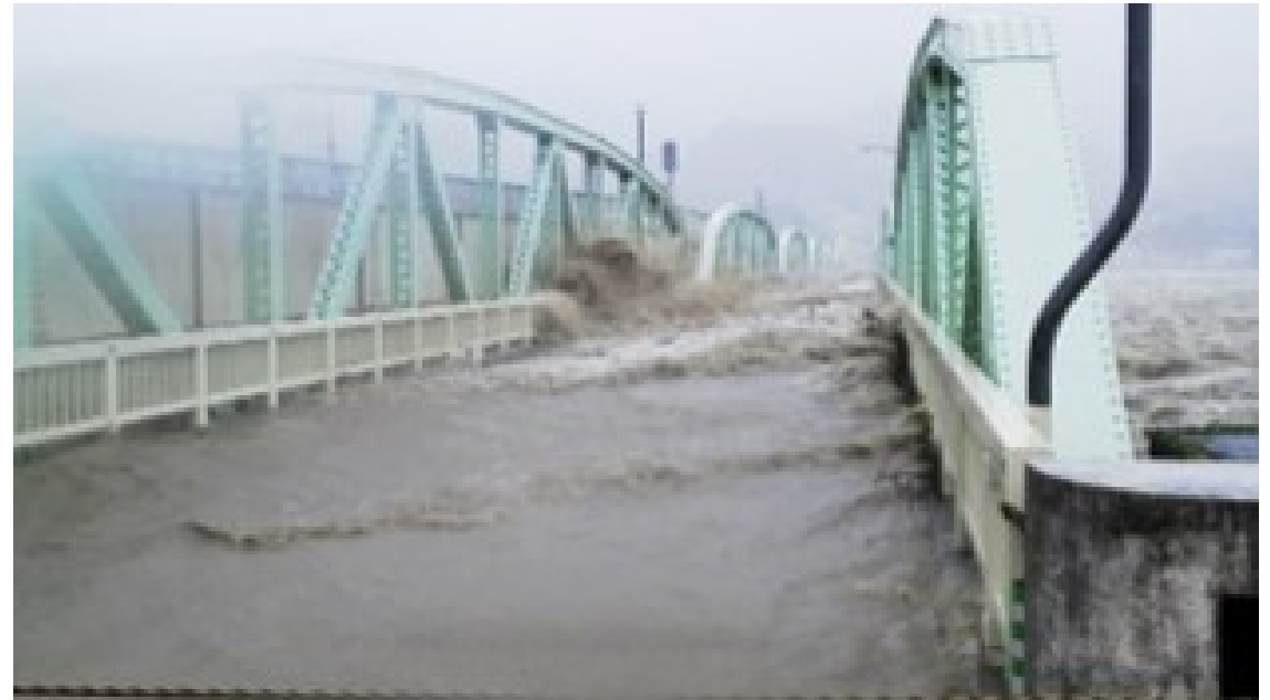
旧熊野川大橋からの越水(右岸)
