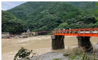
県道小鶴原女木線 深水橋 橋梁流失 (熊本県八代市)
