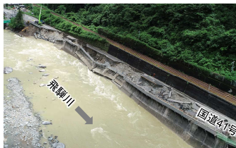
国道41号 道路崩壊 (岐阜県下呂市)
